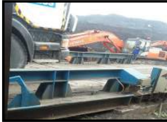
Gambar 4.1. Tidak Menggunakan APD Lengkap
